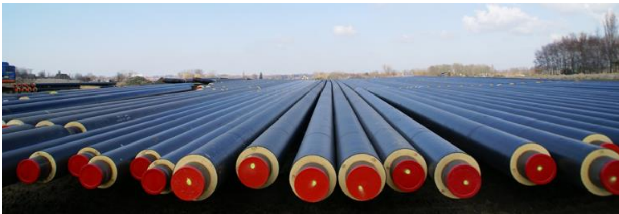
Figuur 1: Buizen van een warmtenet
