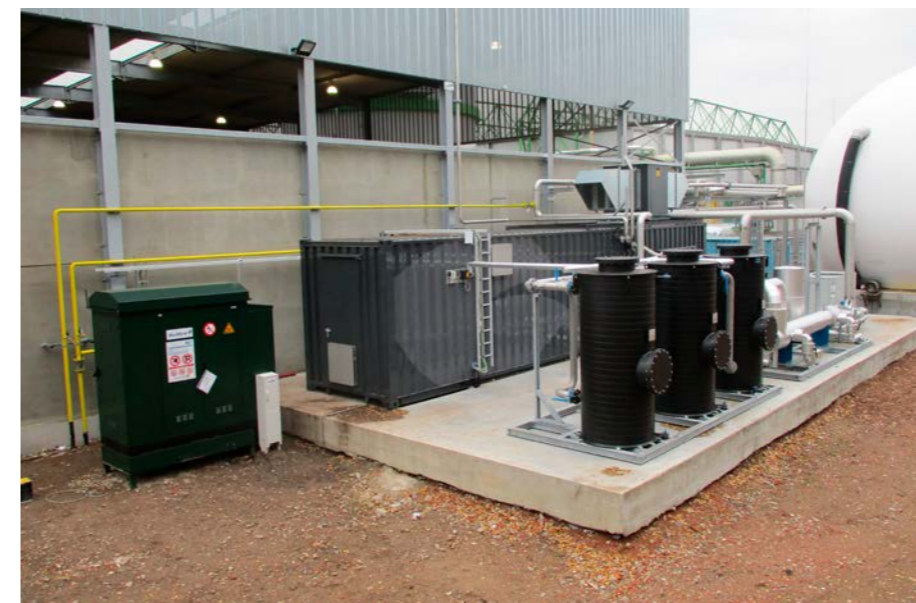
Opzuiveringsinstallatie bij IOK
