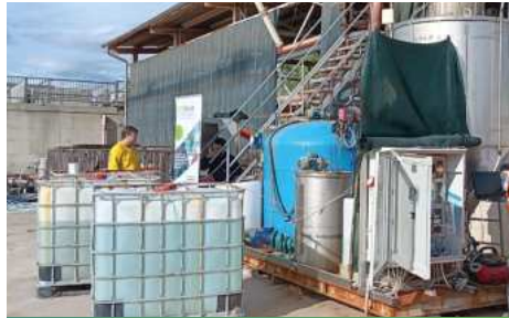
Pilot-zuiveringsinstallatie voor het terugwinnen van struviet uit digestaat
